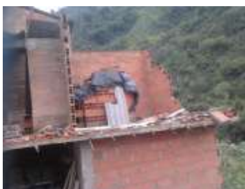
Foto: Habitación derribada por la explosión
